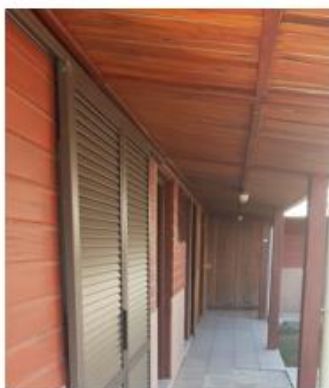
Sous-plafond à reprendre
