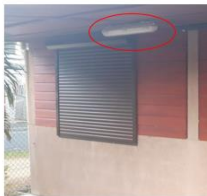
Eclairage à modifier
